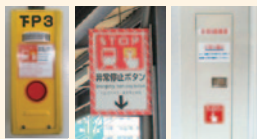
非常停止ボタン 非常通報装置
